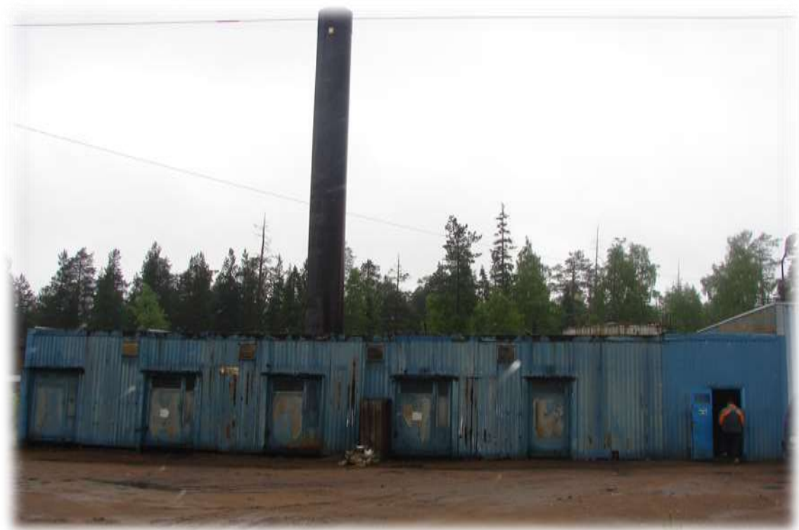
Рисунок 1.2.1.1 – Поселковая котельная Пяозерского ГП
